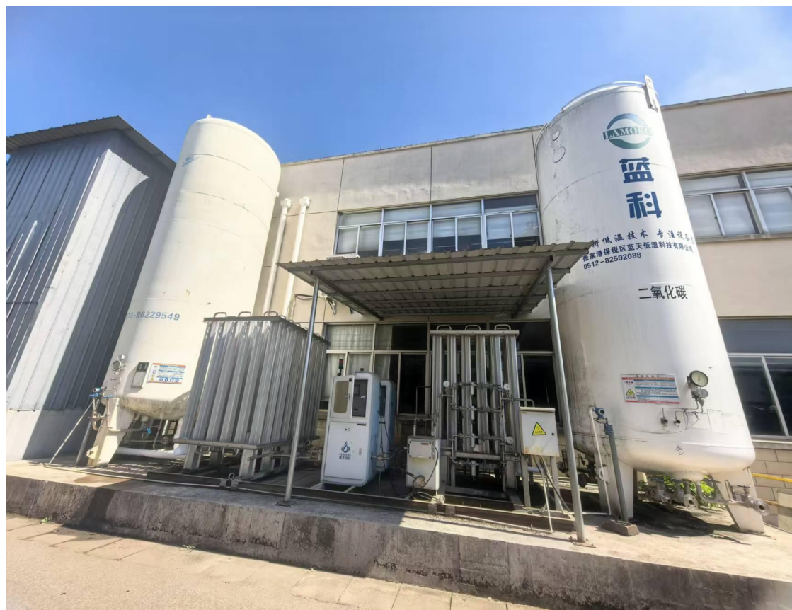
图 2-5 液态二氧化碳、液氩储罐
