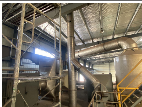
1#生产线流平烘干废气处理设施-2
