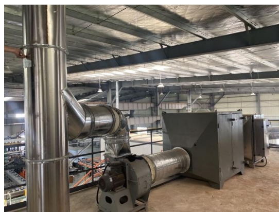
2#生产线流平烘干废气处理设施
