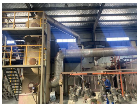
1#生产线喷漆废气处理设施-2
