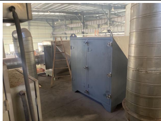
1#生产线流平烘干废气处理设施-1
