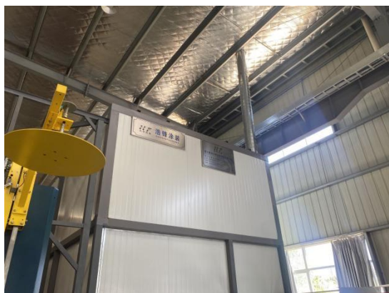
2#生产线流平烘干加热炉烟气排气筒
