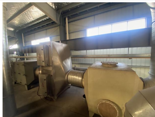
1#生产线喷漆废气处理设施-1
