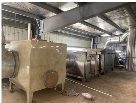
2#生产线喷漆废气处理设施-1
