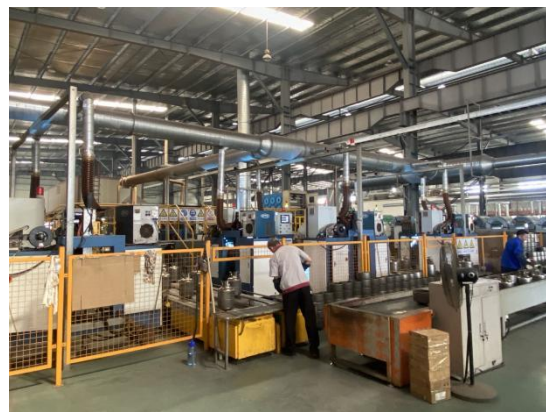
1#生产线电焊岗位及其管道布设
