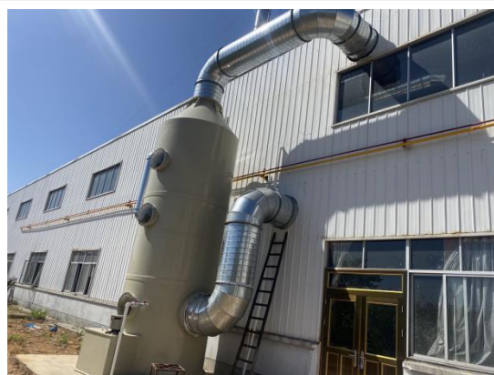
2#生产线喷漆废气处理设施-2
