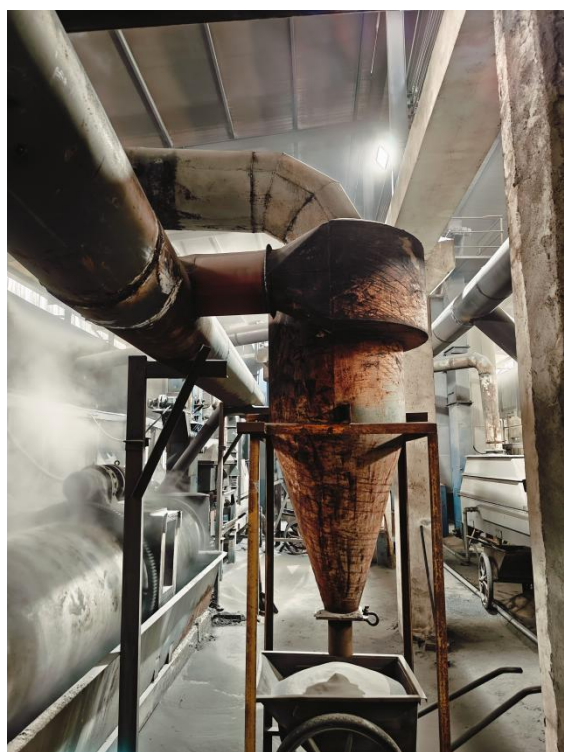
1 号再生砂废气旋风除尘器
