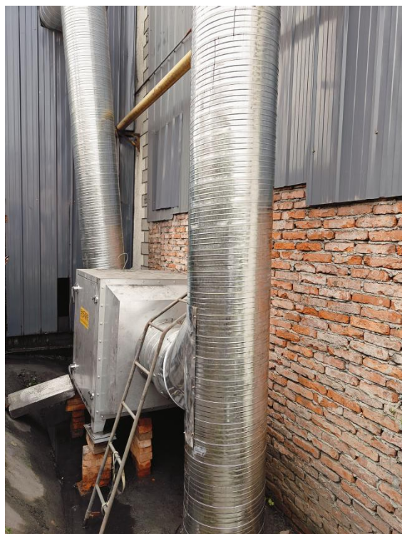
再生砂废气“水喷淋+活性炭吸附”装置
