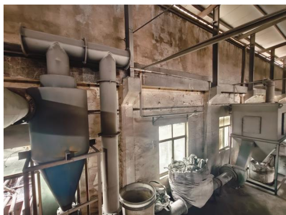
2 号覆膜砂废气“旋风除尘器+布袋除尘器”
