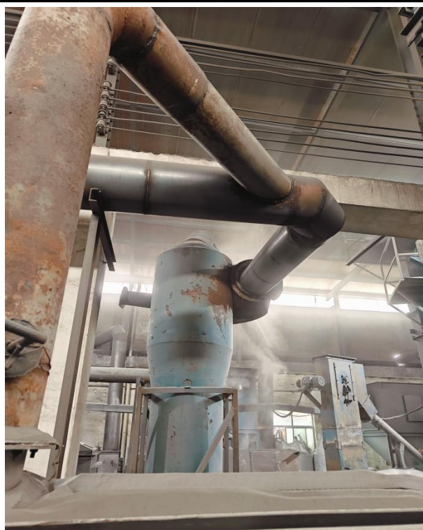
2 号再生砂废气旋风除尘器
