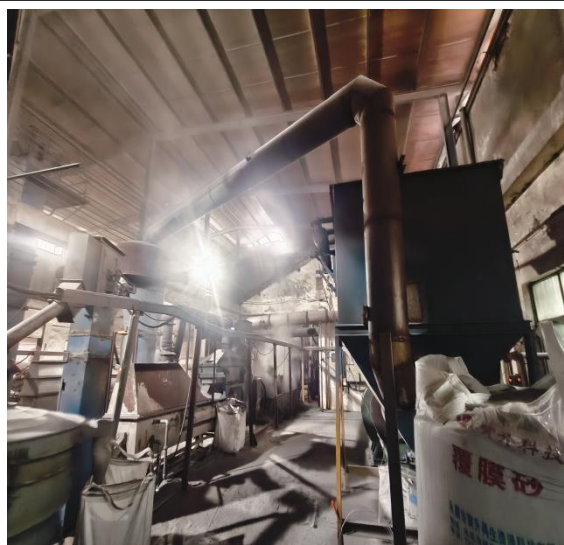
1 号再生砂废气布袋除尘器
