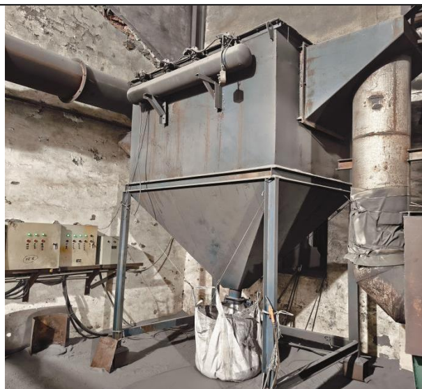
2 号再生砂废气布袋除尘器
