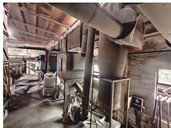
1 号覆膜砂废气“旋风除尘器+布袋除尘器”
