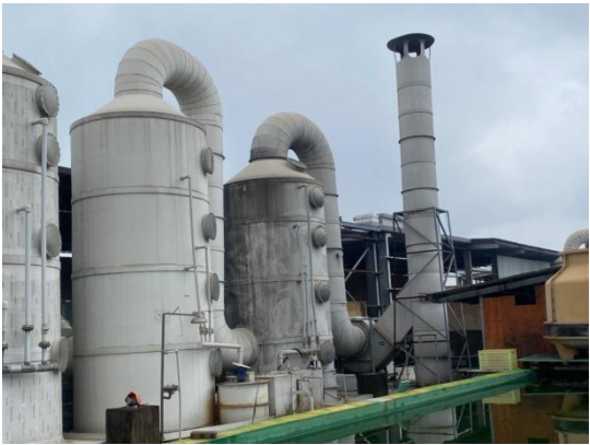
酸洗、电解抛光废气处理设施（备用）
